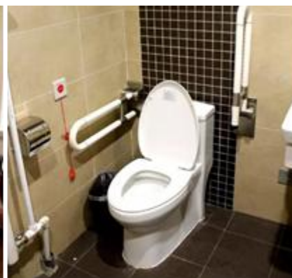
图 2.1.5-3 坐便器后面墙体采用深色瓷砖
